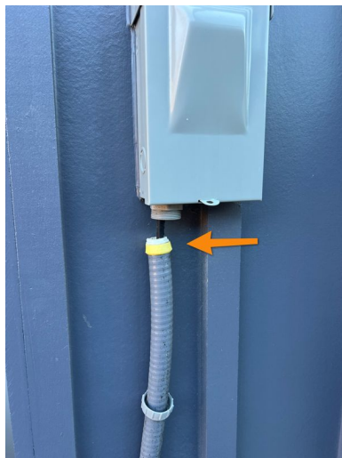
Broken conduit connector
